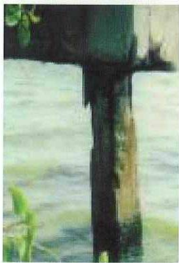
腐食しているコンクリート杭
