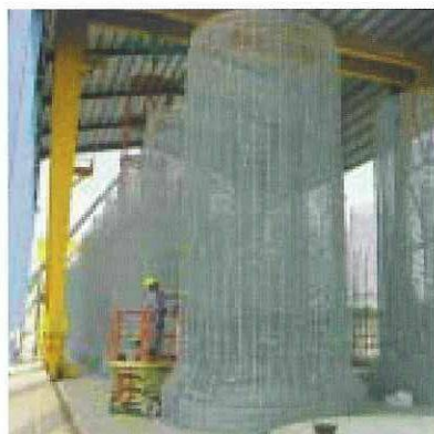
深度地下道下水システム、シンガポール
